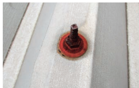
部材要因：ボルトの腐食
