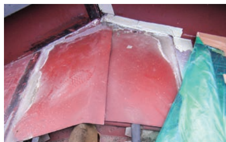
構造要因：接合部分の変形
