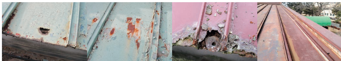
塗膜要因：錆の進行による腐食
